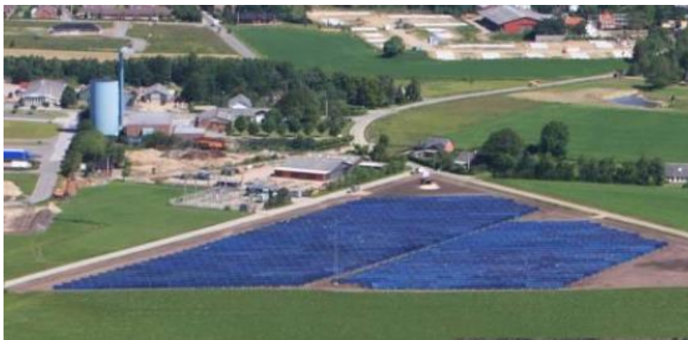
Abbildung 6-12: Solarthermie-Freiflächenanlage zur Unterstützung der Fernwärmeerzeugung in Gram (DK) Quelle: www.stoffstrom.org
