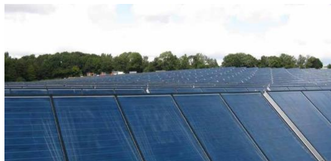
Abbildung 6-13: Solarthermie-Kollektoren in Broager (DK) Quelle: www.stoffstrom.org
