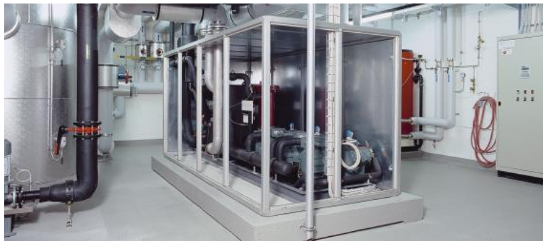
Abbildung 6-16: Großwärmepumpe in einer beispielhaften Darstellung Quelle: www.kwt.viessmann.com
